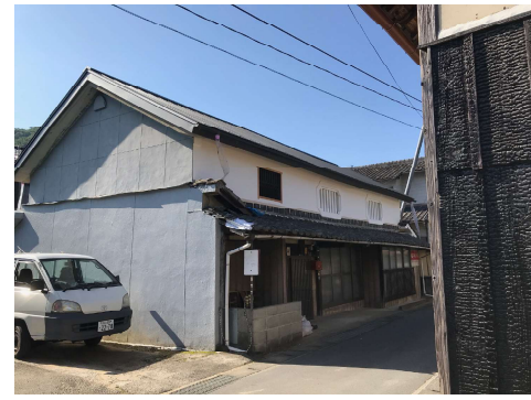
2階の外壁の漆喰を塗り替えて、樋を付け替え、下屋根の補修をして完成。
